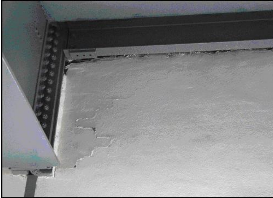
Abb. 12 Mauerwerkschaden an der Ausfachung einer Hallenwand.
