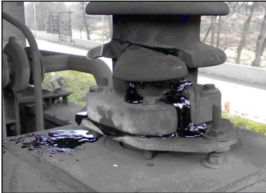
Abb. 14 Beschädigter Isolator eines Trafos.
